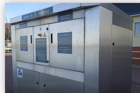
Système de pompage des eaux noires à Dives-sur-Mer
